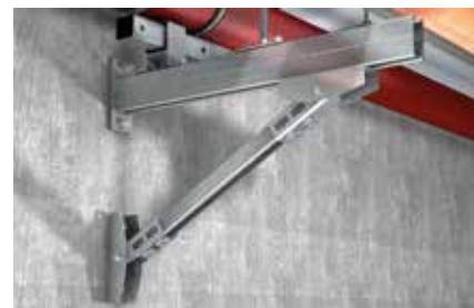
Tubazione pesante su mensola
