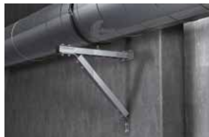
Condotta d'aria circolare su mensola
