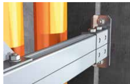
Installazioni di batterie di tubi
